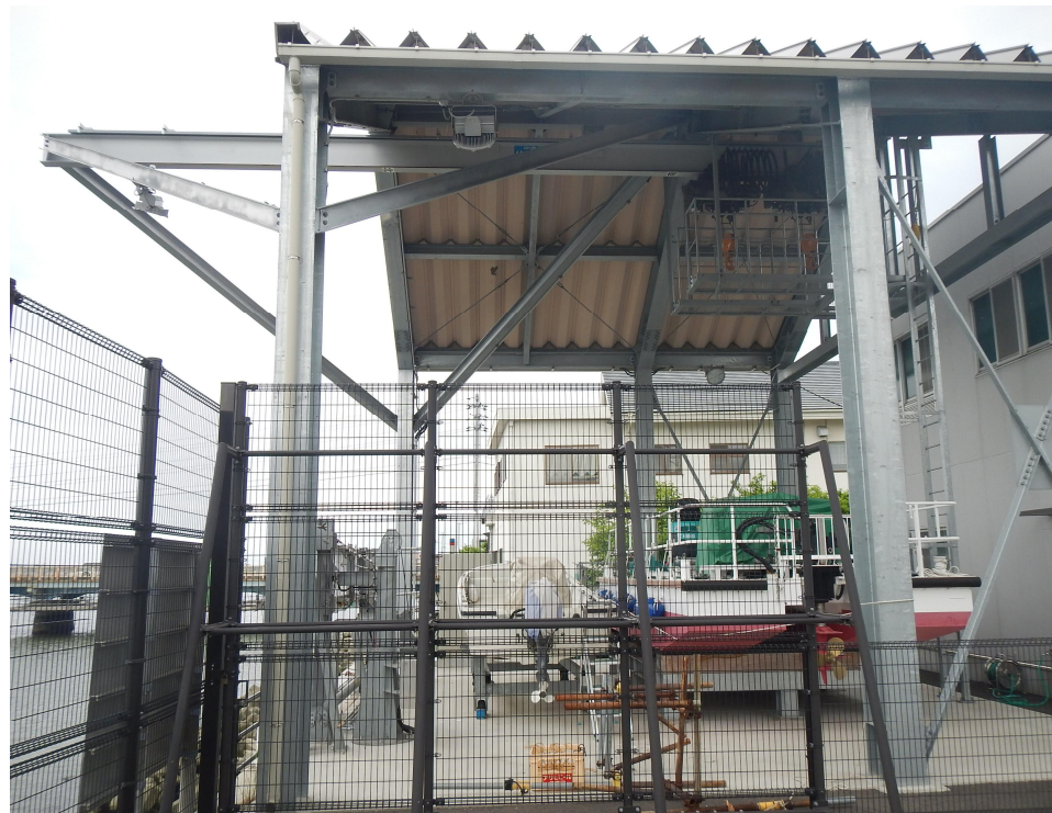
天井クレーン全景
